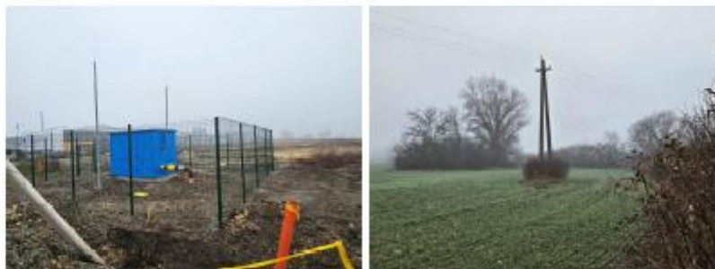
Gázfogadó a 064/56 hrsz-en, középfeszültségű oszlop a 064/55 hrsz-en
